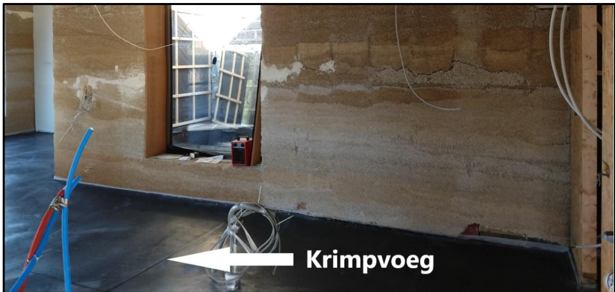
Afbeelding 2: Krimpvoeg in een gepolierde betonvloer
