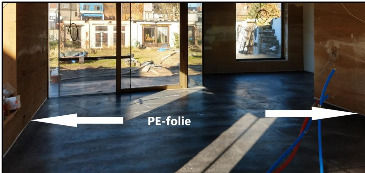
Afbeelding 1: De PE-folie die bovenop de vloerisolatie is aangebracht is nog zichtbaar aan de randen na het gieten van de dekvloer.
