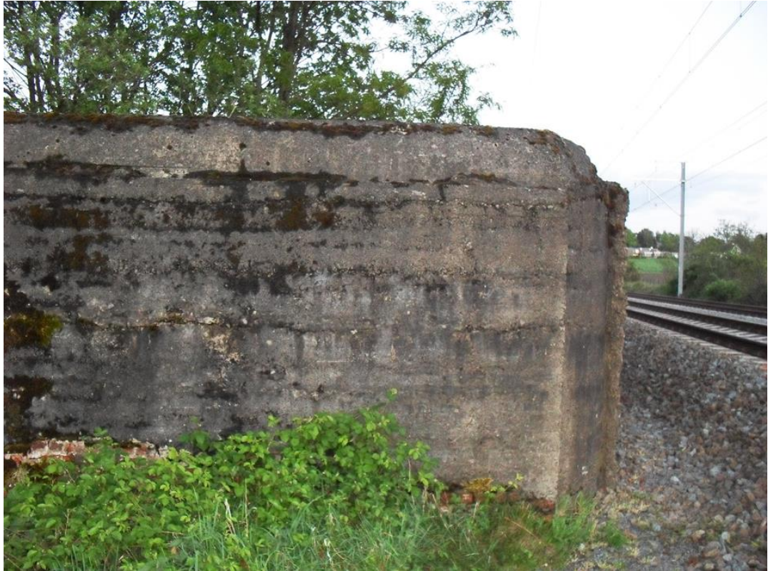
Bunker D19: in slechte staat
